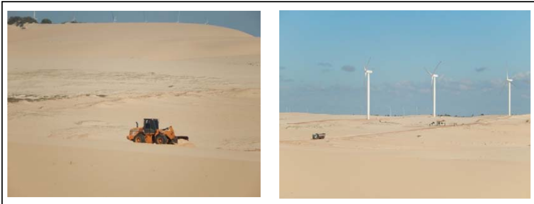
Figura 3 – Maquinário do parque eólico nos campos de dunas
